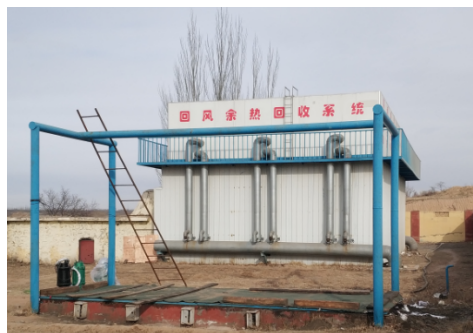
图3 余热回收装置实物图
