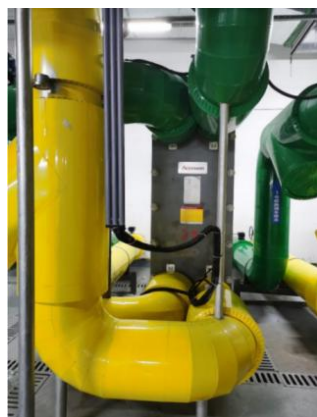
图 12 冷冻水系统一次侧与二次侧换热板换
