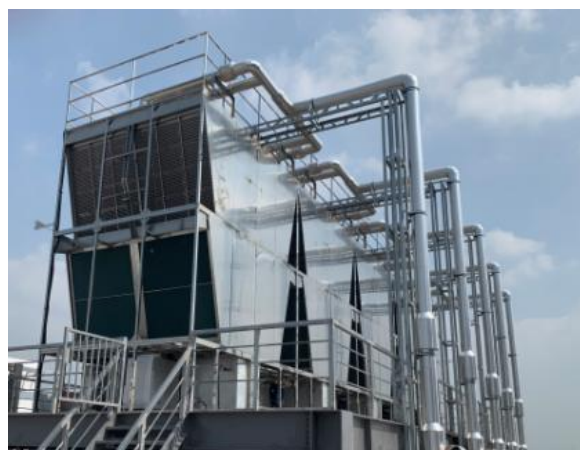
图 4 露点型间接蒸发冷却塔
